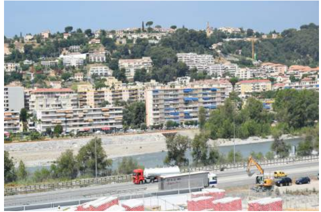
Fig. 8 / Chantier de la future toiture végétalisée en premier plan en proximité de la zone Natura 2000 du Var©Cerema
