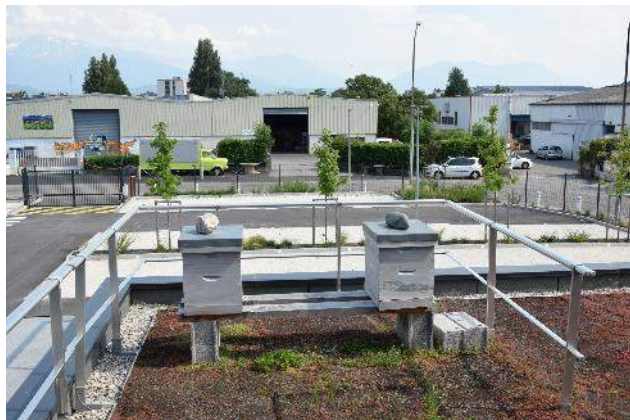
Fig. 10 / Ruches et toiture en sédum du centre technique@cerema
